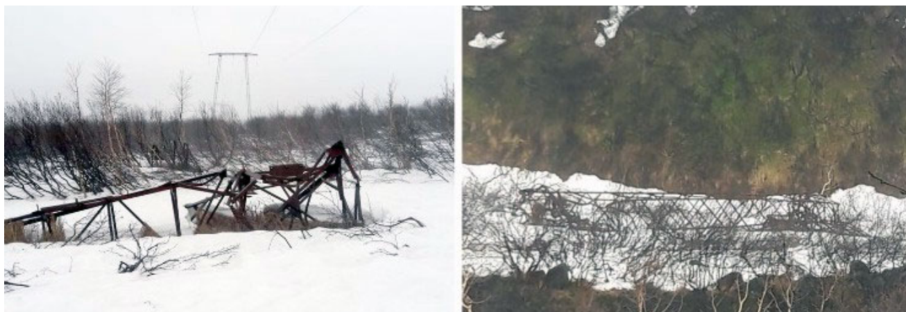
Рис. 2. Опора линии электропередачи, опрокинута снежной лавиной. Западное основание вулкана Вилучинский. 7.06.2020 г. Фото А.Г. Терещенко.
