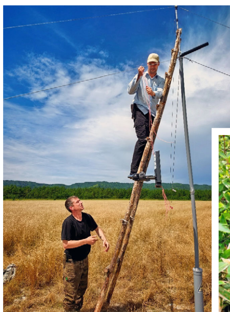
Установка камеры для видеомониторинга на Пугачевском грязевом вулкане, 2025 г.
