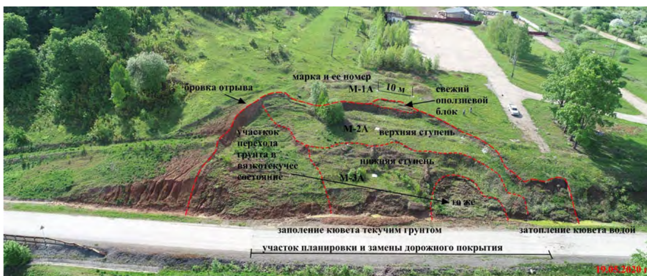
Рис. 1. Строение активного техногенного оползня по автодороге на горнолыжный комплекс «Аджигардак», Ашинский участок Челябинской области (снимок БПЛА). Фото здесь и далее А.А. Худякова
